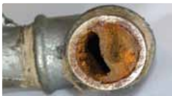
Potrubí s usazeným vodním kamenem
