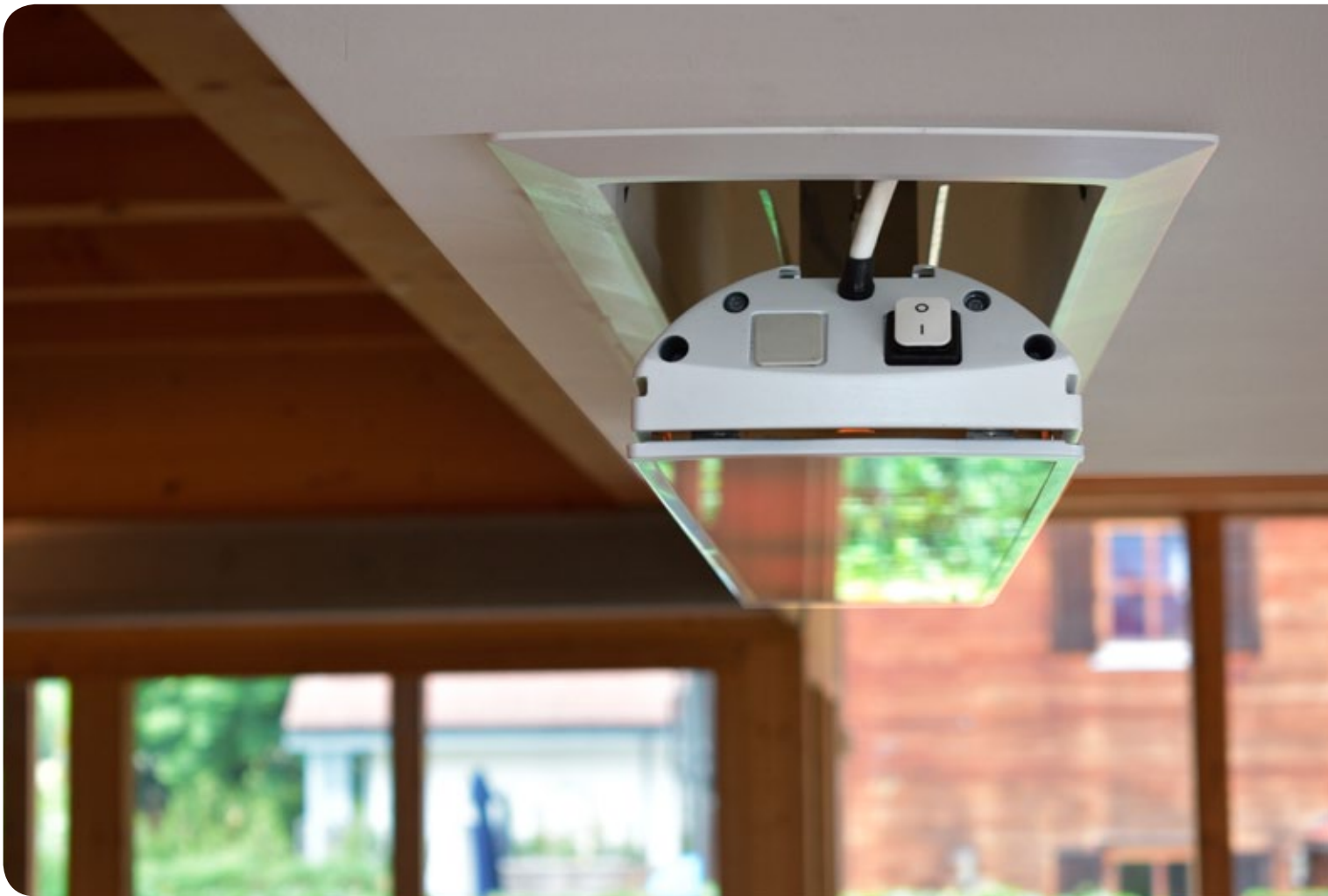
Flächenbündiger Deckeneinbau, Sauerlach · Deutschland
